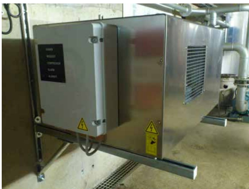
CS 130 en station de pompage
